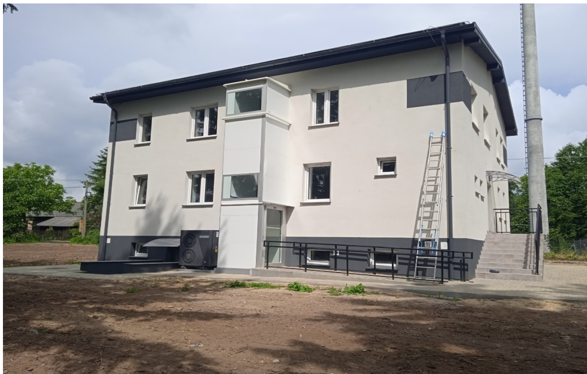
Fot. nr 8 Przebudowa budynku mienia gminnego na świetlicę wiejską w msc. Orchowiec
